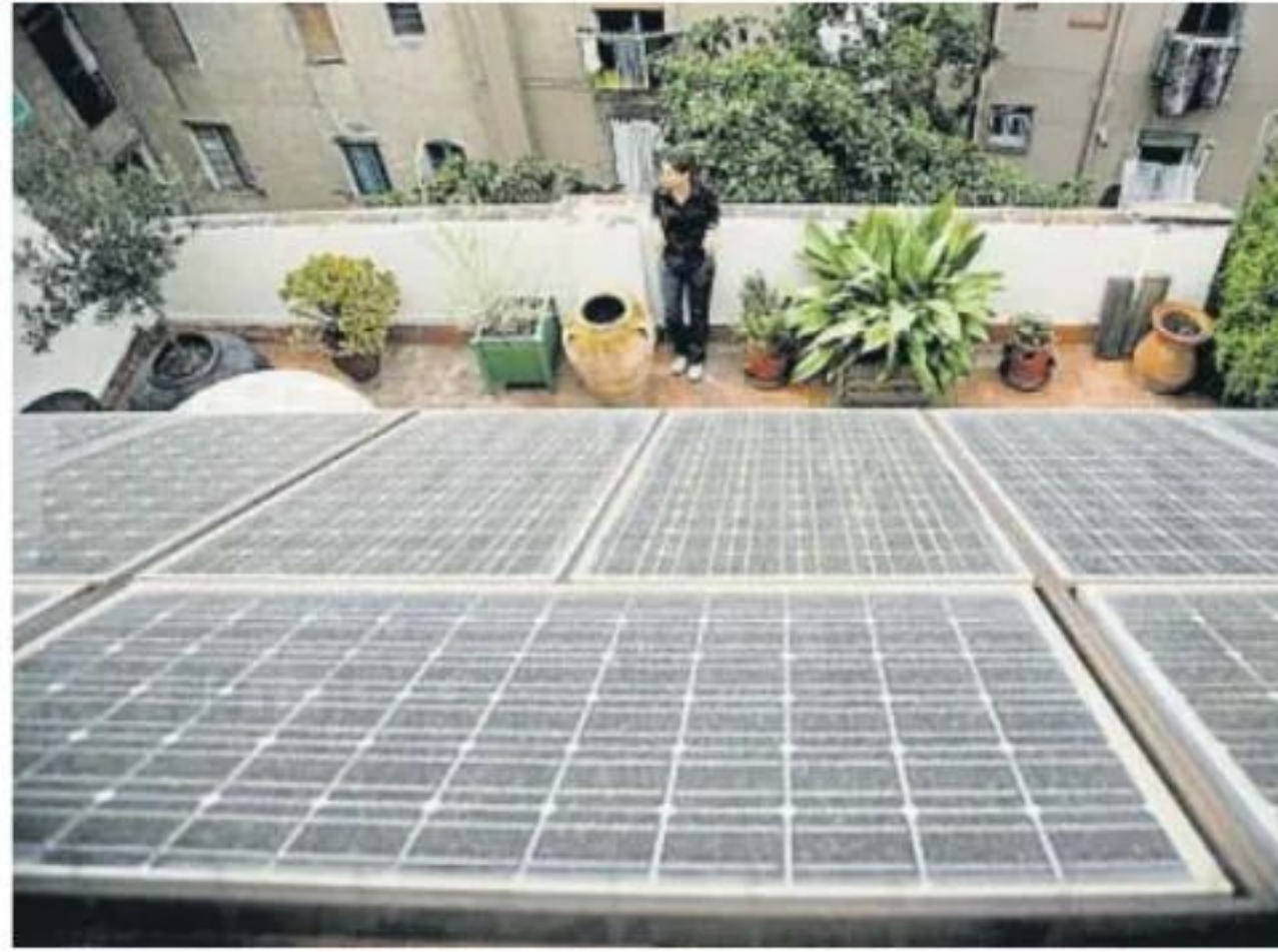
Instalación de autoconsumo en un edificio
